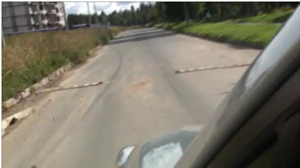
Рисунок 8.3 – Неудовлетворительное состояние ИДН, отсутствие ТСОДД
