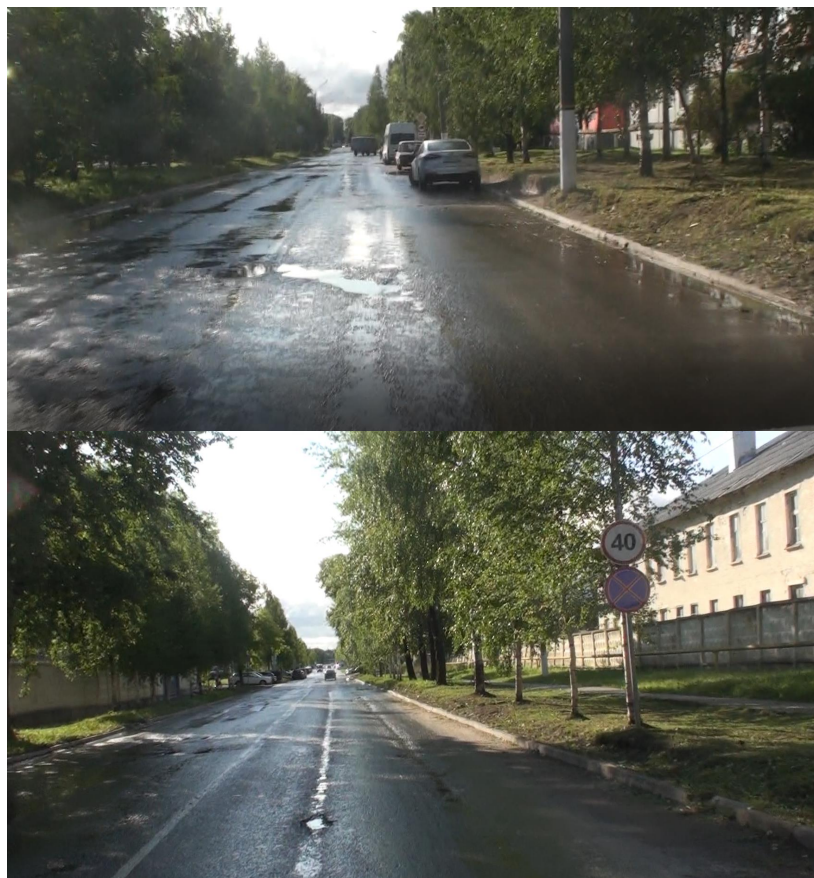
Рисунок 8.1 – Неудовлетворительное состояние проезжей части (выбоины, колеи)
