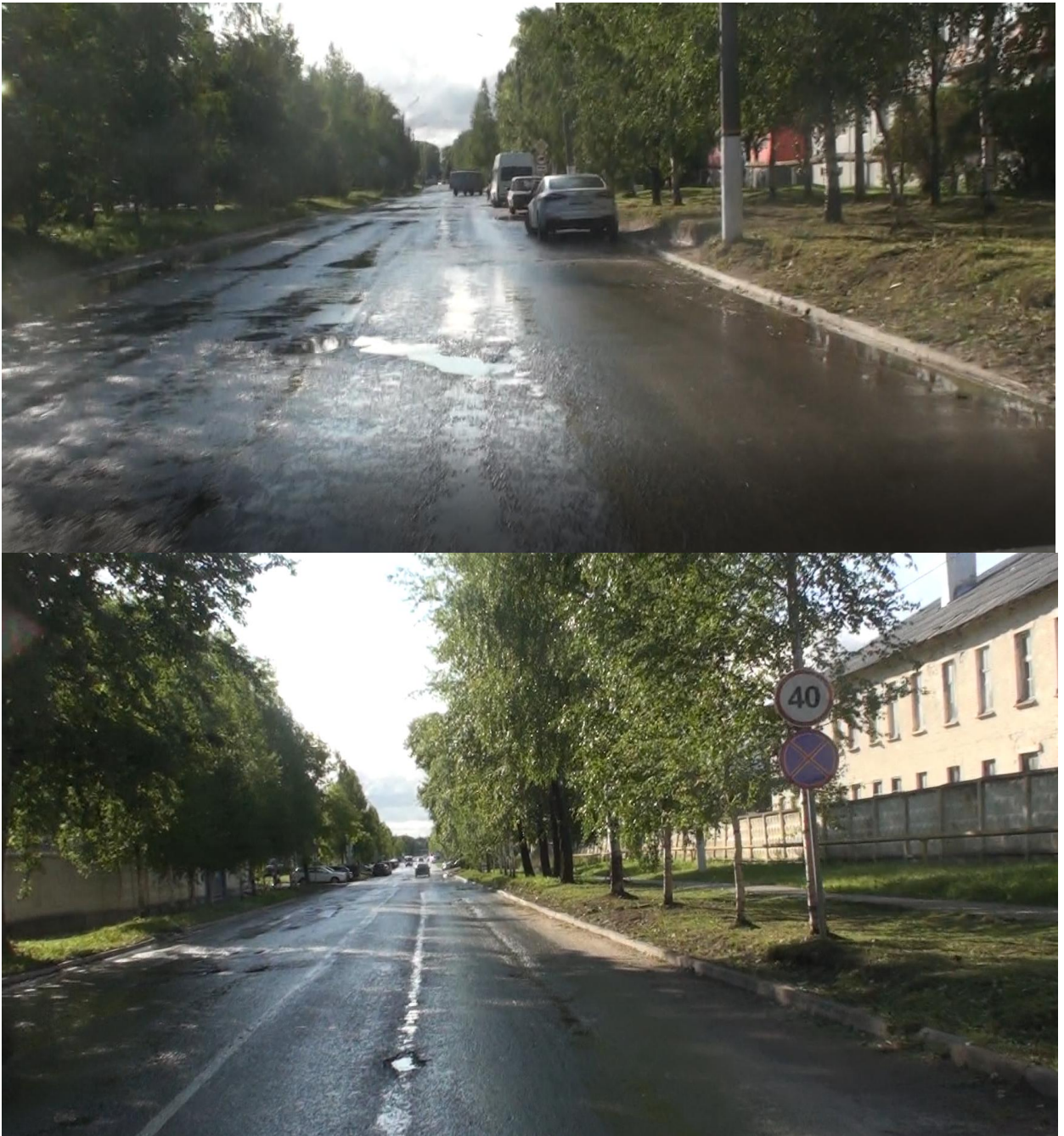
Рисунок 8.1 – Неудовлетворительное состояние проезжей части (выбоины, колеи)
