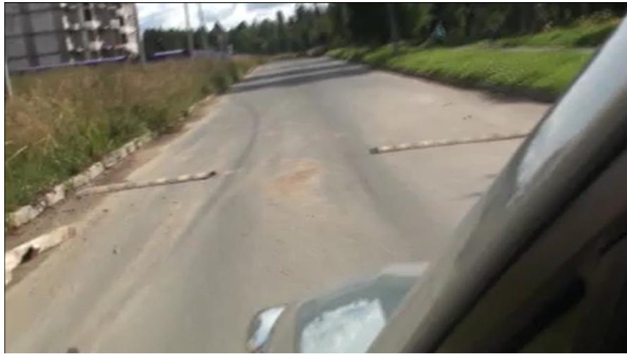
Рисунок 8.3 – Неудовлетворительное состояние ИДН, отсутствие ТСОДД
