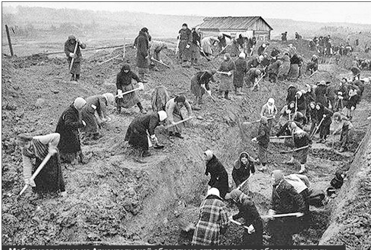
Мобилизованные из Архангельской области на строительстве оборонительных сооружений в Карелии. Фото 1941-1942 годов
