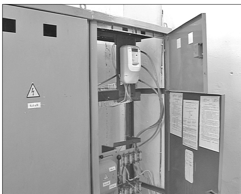
На фото: Вводно-распределительный узел с двухтарифным счетчиком
