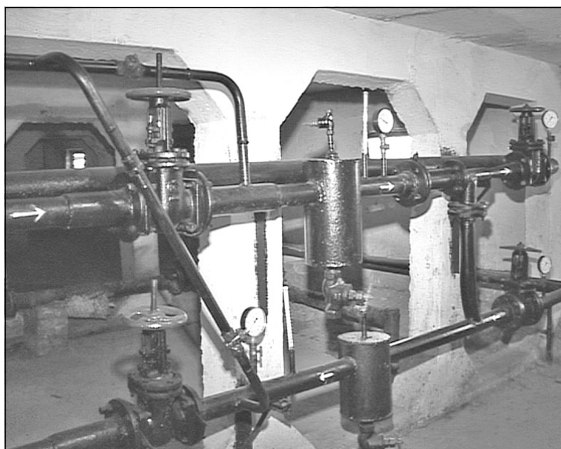
На фото: Тепловой узел
