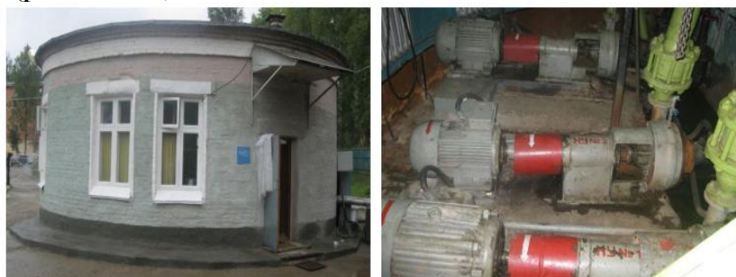
Рис. 2.1.2. Общий вид КНС и насосных агрегатов
