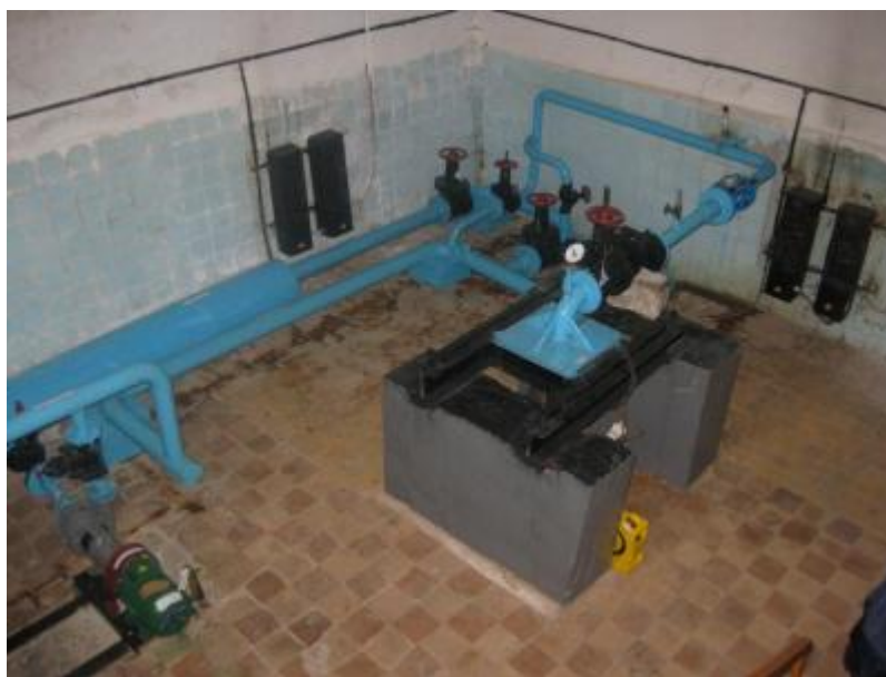
Рис. 1.1.4. Водозаборный комплекс очистных сооружений
