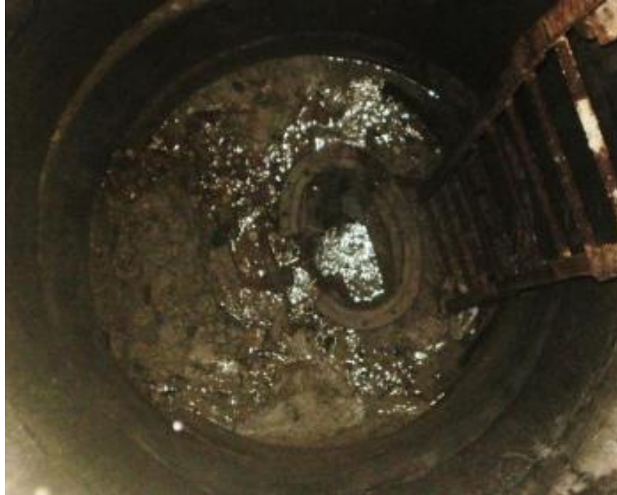
Рис. 1.3.2. Течь водовода в колодец
