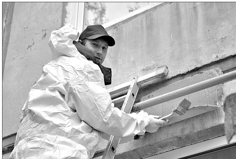
Желтую краску газопроводов, которые ждали газа 6 лет, необходимо обновить
