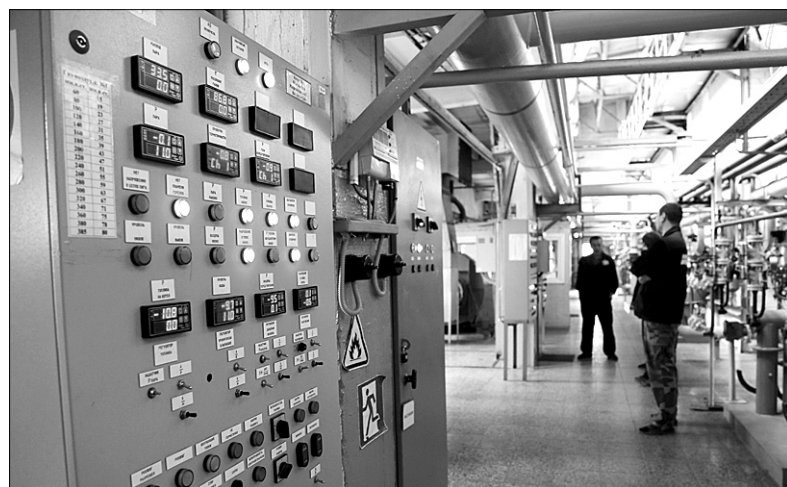
На фото: МУП «ЖЭУ» Внутри котельной чисто как в операционной и все автоматизировано
