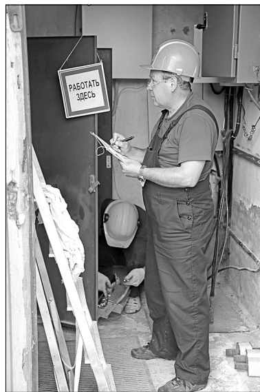
На фото: Мирнинские городские электросети. Оформление протокола по результатам технического обслуживания электрооборудования
