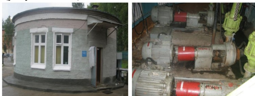
Рис. 2.1.2. Общий вид КНС и насосных агрегатов
