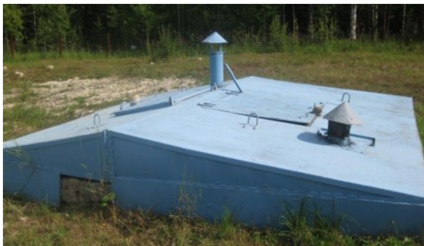
Рис. 1.1.6. Вид насосной станции 1 подъема
