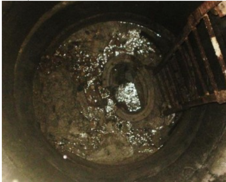
Рис. 1.3.2. Течь водовода в колодец
