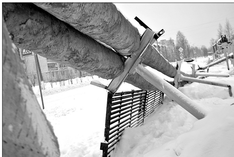
На фото: Теплотрассу явно «штормит» после праздников...
