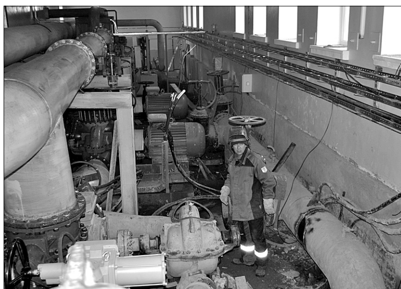
В машинном зале
